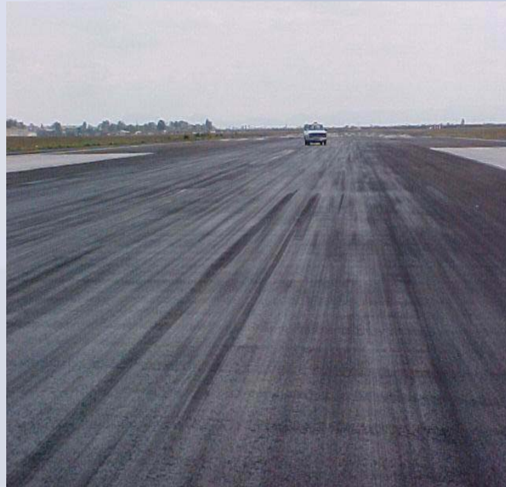
RWY - Falta de mantenimiento
