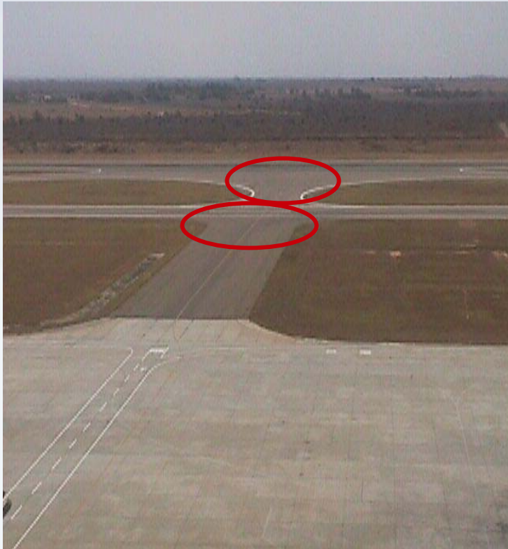
Falta de marcación adecuada
