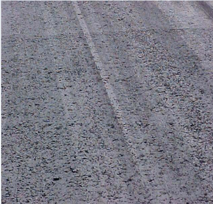
RWY - Falta de mantenimiento
