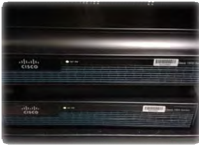
Routers instalados por el proveedor de servicios
