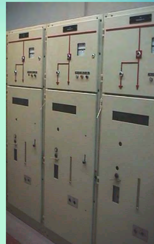
Entre las rutinas de mantenimiento preventivo se encuentran las termografías de tableros primarios
